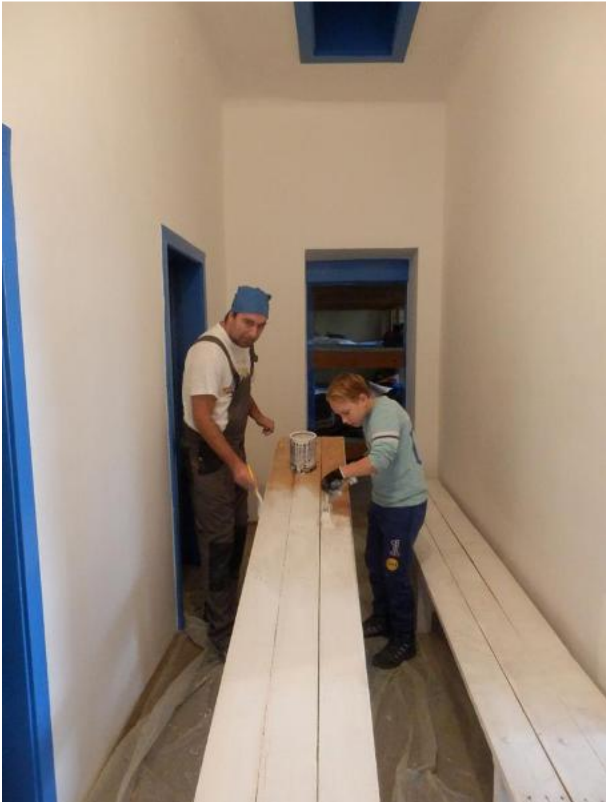
Uređenje stajališta u hodniku. Na slici se vidi kako se koristi jedna od vrsta materijala za uređenje stajališta: HDPE (High Density Polyethylene) .
